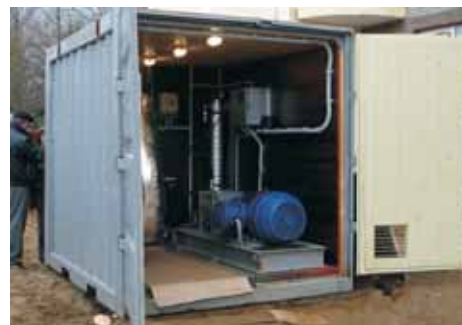
Фото 2. Общий вид БМТП-55.
